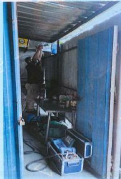
饭堂油烟处理后排放口
