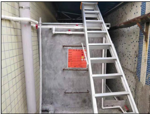
生产废水暂存池
