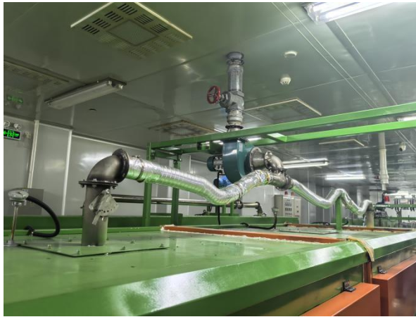
隧道式烘干炉废气收集管道
