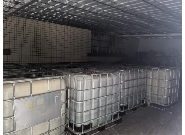
零散废水暂存间内部
