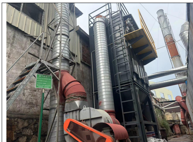
焙烧、熔融、浇注废气治理设施 DA001
