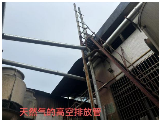
燃烧废气排放口 DA002
