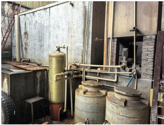
生产废水处理设施
