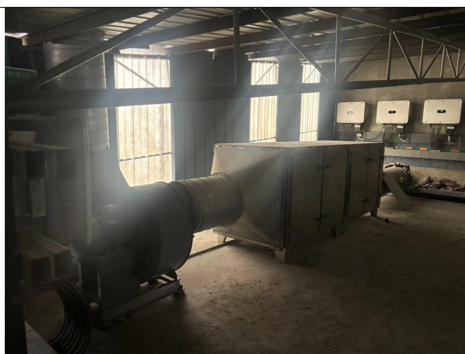
融蜡、组树、射蜡、脱蜡及脱模剂废气处理设施 DA003
