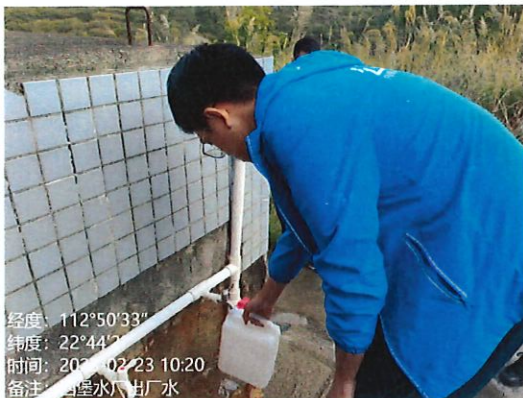
四堡水厂出厂水采样口
